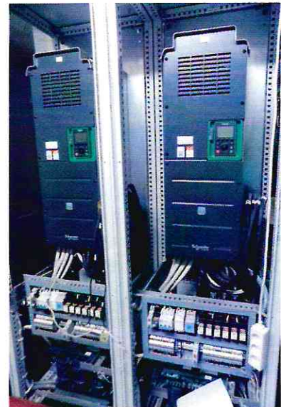
Фото 8.1. – Частотные преобразователи на приводе дымососа и вентилятора на паровом котле №4.
