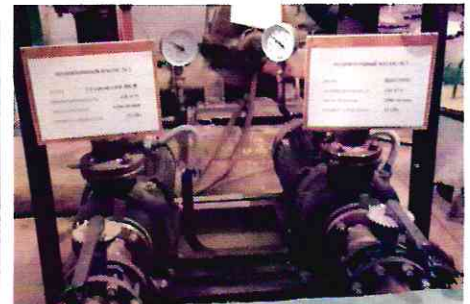
7.3. Насосная станция ХВО
