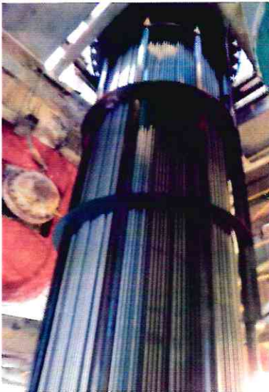
Фото 2.1. – Трубная система ПСВ 3
