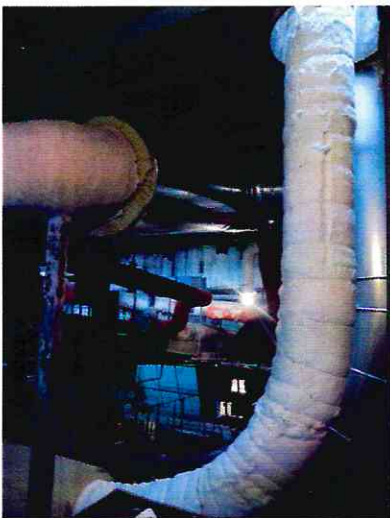
Фото 3.1. – Паропровод (компенсатор П-образный)
