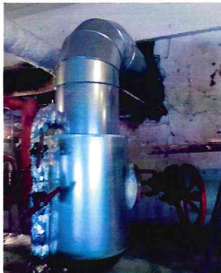
Фото 3.2. – Паропровод (участок к паровому котлы №2)
