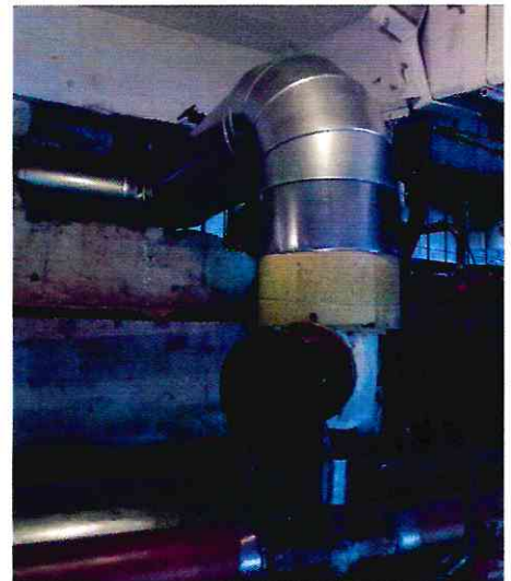
Фото 3.3. – Паропровод (участок к паровому котлу №4)
